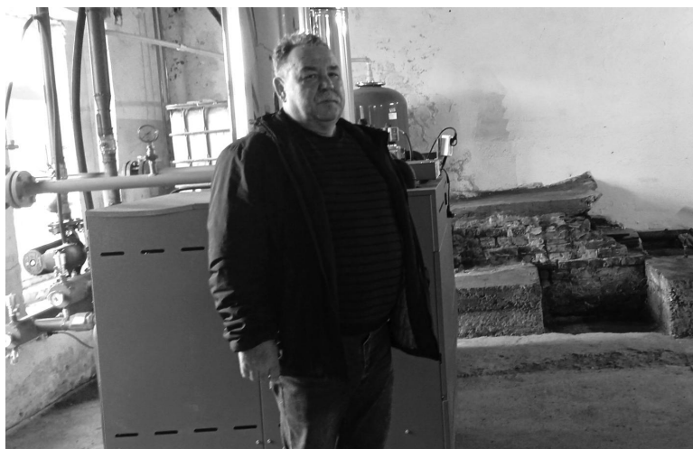
• С.М. Королёв в газовой котельной МБУ «Городское хозяйство»
